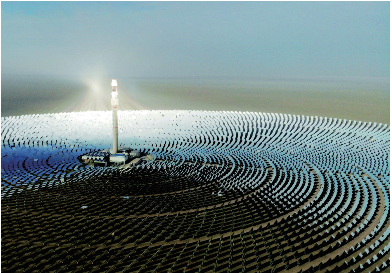
根据“十四五”规划和2035年远景目标纲要，中国将推动能源清洁低碳安全高效利用，加快新能源、绿色环保等产业发展，促进经济社会发展全面绿色转型。图为2021年2月24日用无人机拍摄的首航高科敦煌100兆瓦熔盐塔式光热电站，其位于甘肃省敦煌市向西约20公里处，被称为“超级镜子发电站”。
